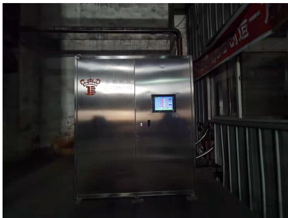
3 号炉脱硝（新建锅炉）
