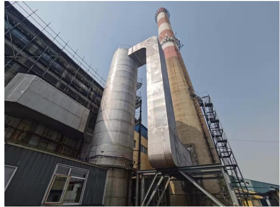
脱硫塔（新建锅炉）及烟囱（依托原有）
